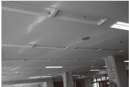
節電のために、使用頻度の高いところはLED化し、支障のない部分は蛍光管を取り外している役場庁舎の照明
