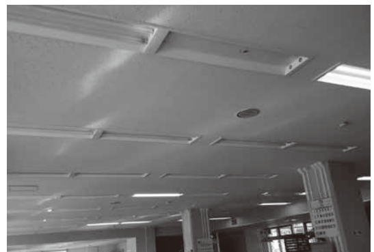
節電のために、使用頻度の高いところはLED化し、支障のない部分は蛍光管を取り外している役場庁舎の照明
