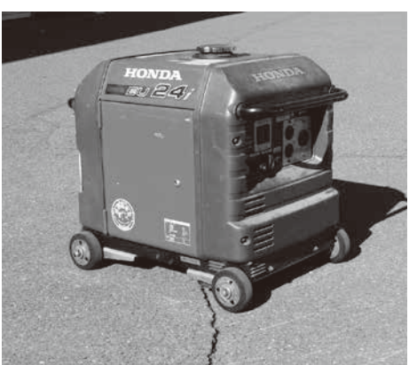
役場に備蓄している発電機
